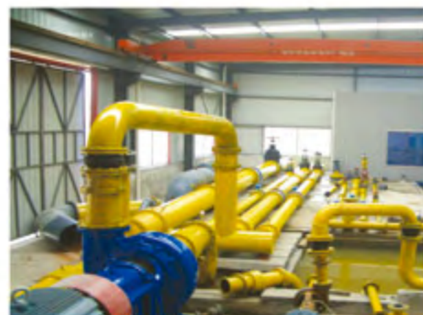
▲ 喷嘴测试泵站
